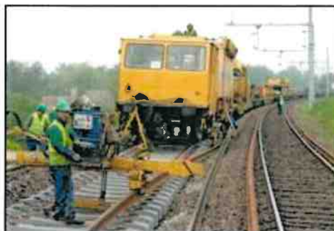
Longs Rails soudés sur traverses béton
