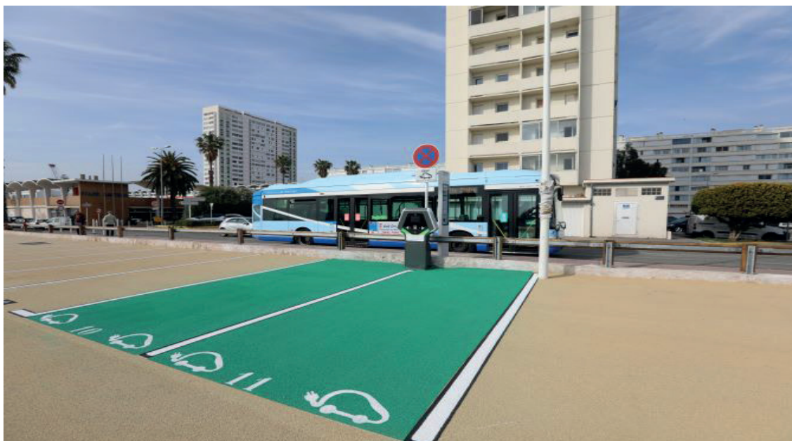
Borne de recharge électrique
